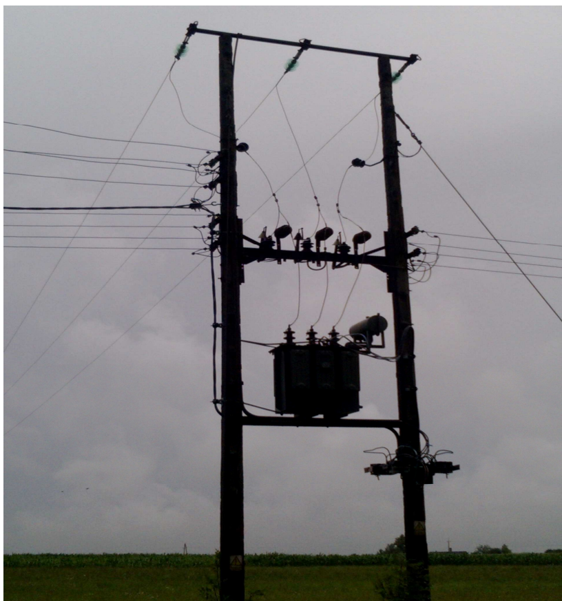
Ryc. 15 Wypracowana i wymagająca wymiany stacja transformatorowa 15/0,4KV typu ŻH -15-20/100 na terenie Gminy Brzuze
